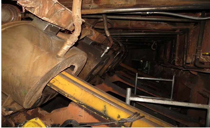
Agitadores de hebra instalados en la máquina de colada continua
